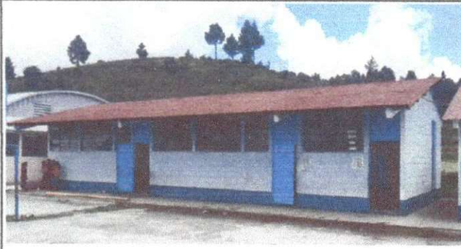
Foto1: Aula No. 1, 2, y dirección, La cubierta se ha deteriorado por corrosión que esta provocando filtraciones de agua.
