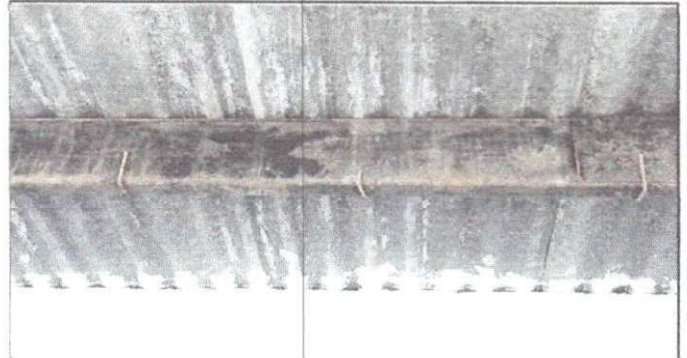
Foto 2: Aulas 1, 2, y Dirección, el mantenimiento de estructura de soporte se necesita lijado y pintura.
